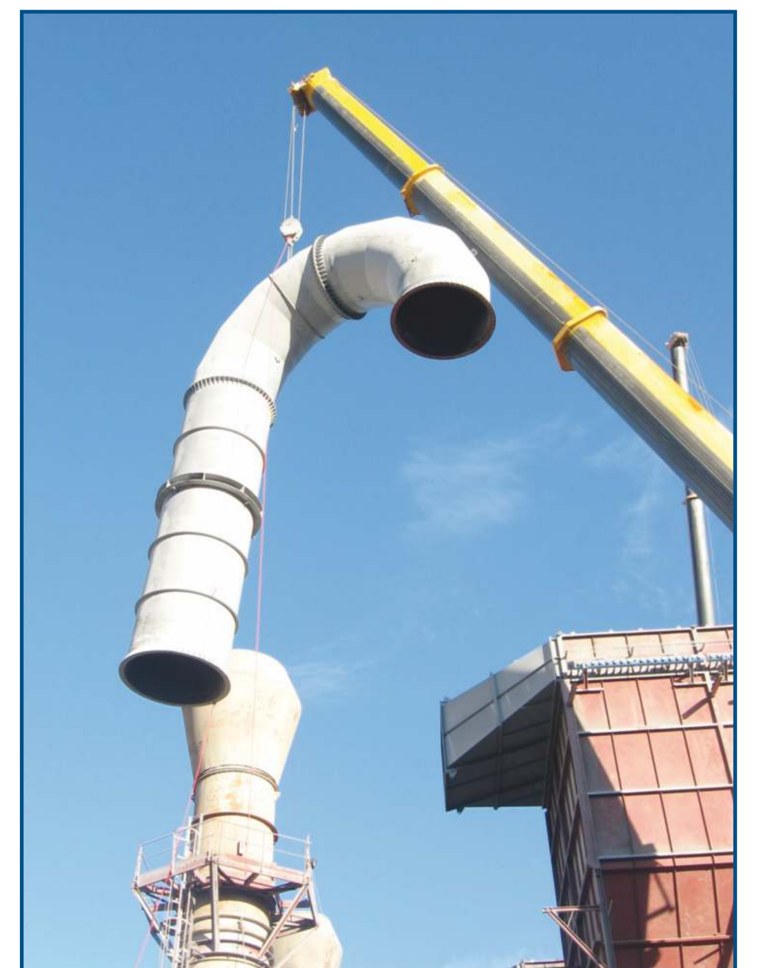
FILTRE À MANCHES CIMENTERIE SCAEK
